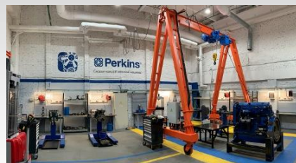
Обслуживание и ремонт ДГУ и ГПУ
