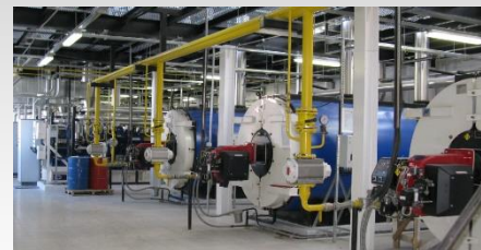
Оборудование инженерных систем
